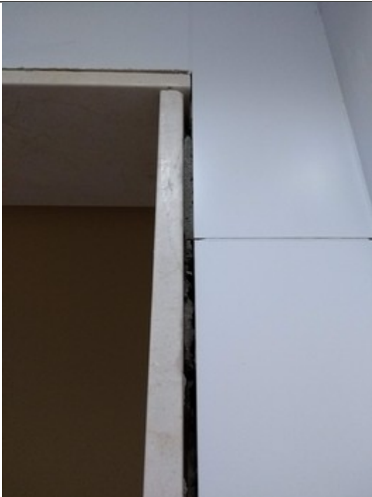
FIGURA 1 – Fresta entre o portal e o revestimento interno do Lavabo a ser corrigida.
