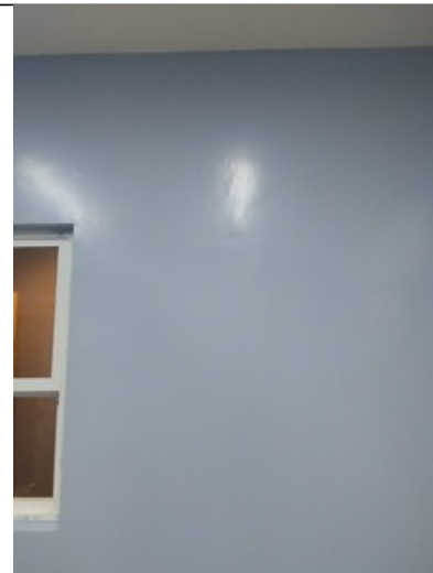
FIGURA 10 – Trecho da Cirurgia apresentando irregularidades da superfície (emassamento irregular).
