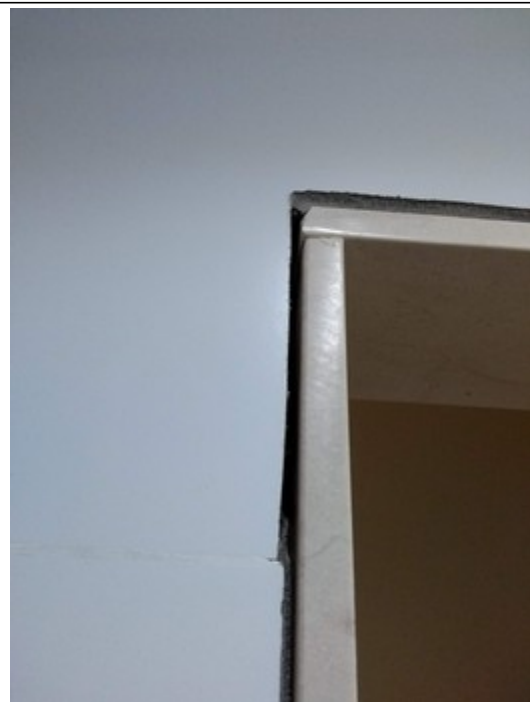
FIGURA 2 – Corte irregular das peças do portal do Lavabo (atenção para a quina da peça superior que ficou quebrada, sem acabamento).
