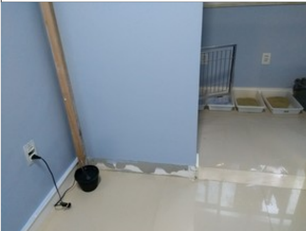
FIGURA 5 – Base da parede da porta da Recuperação. Regularizar e pintar na mesma cor da parede.
