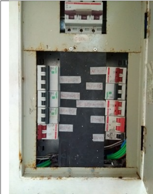
FIGURA 15 – Quadro de disjuntores distribuídos e identificados .
