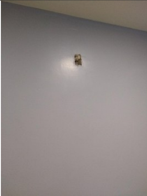
FIGURA 3 – Preencher com gesso o buraco para instalação em local equivocado do ar-condicionado na parede da Ultrassom. Repintar a parede.
