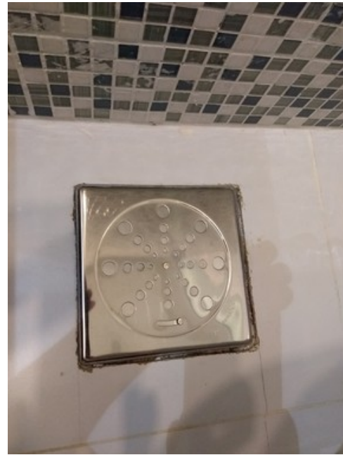
FIGURA 6 – Ralo do Lavabo já instalado. Faltando rejuntar suas bordas. Ver se ainda tem o rejunte branco, senão, providenciar para esta e outras demandas gerais da clínica.
